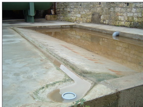
Tri des effluents (bouchon) avec système déboureur et déshuileur (source CA Aisne)
